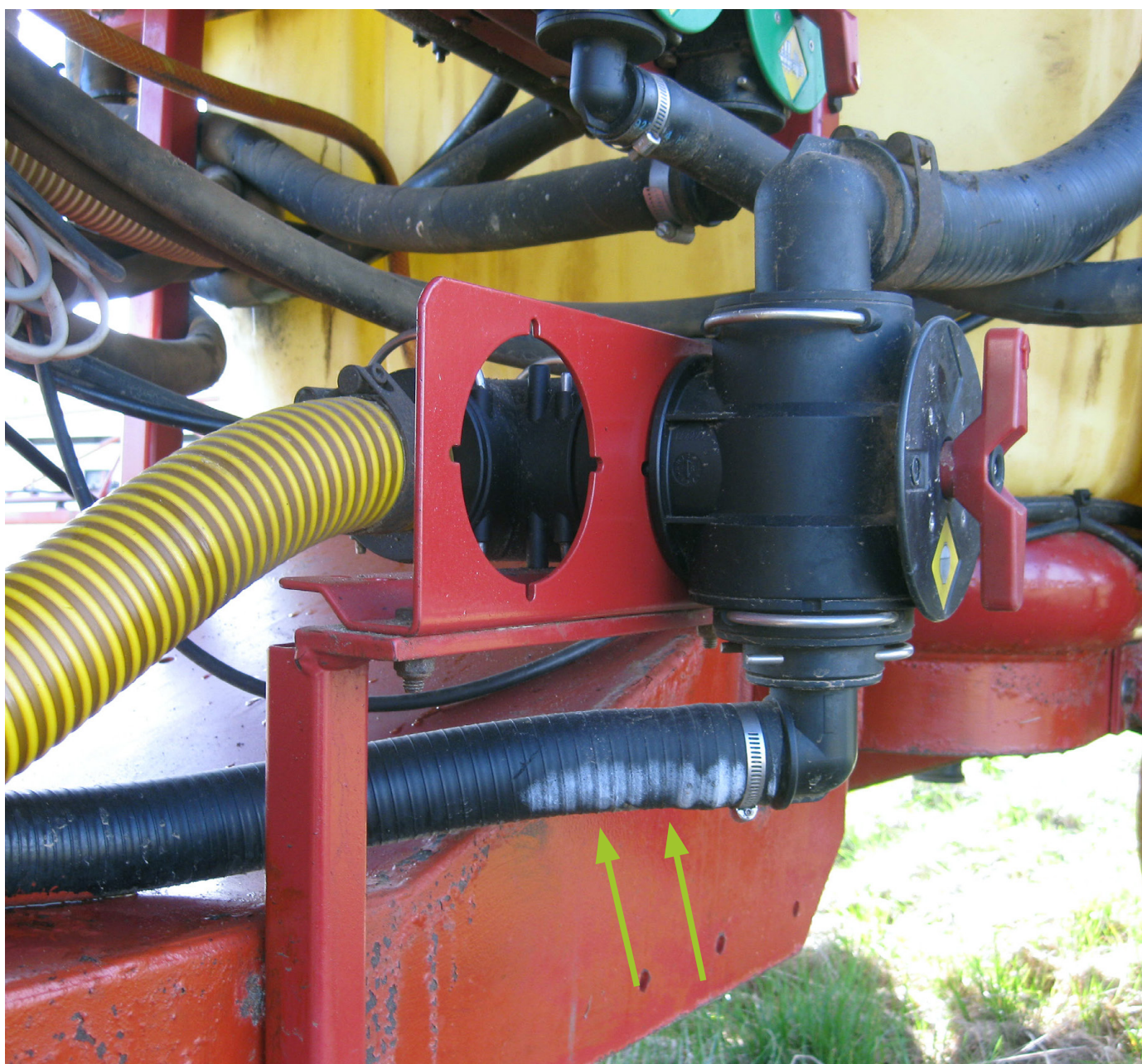
Deformerad slang, byt ut i tid!
