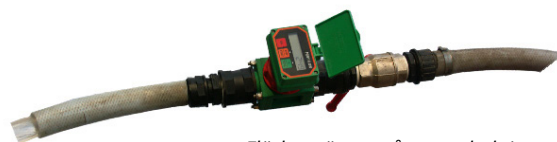
Flödesmätare på vattenledningen.
