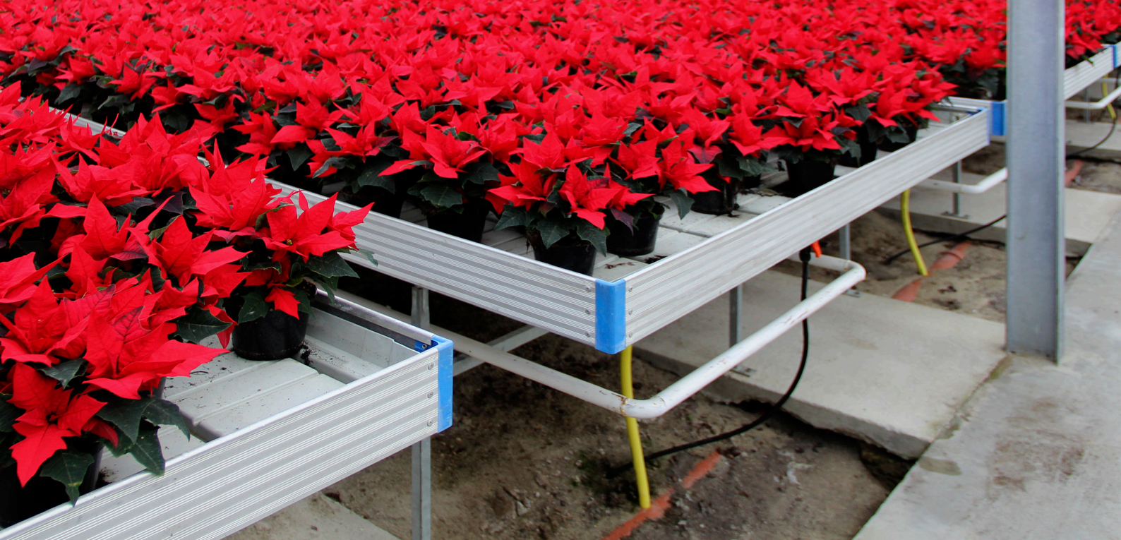
Ebb- och flodbord med ventiler som styr tillförsel och tömning
