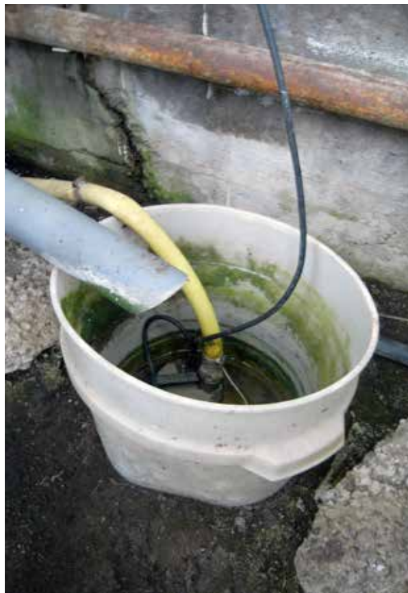
Uppsamling i tunna med dränkbar pump
