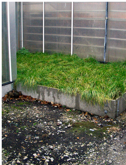
Invändig påfyllnadsplats med uppsamling till utvändig biobädd.
